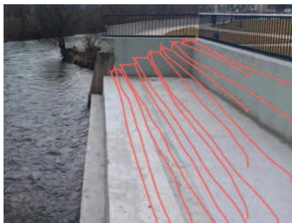
Fig. 19. Gradene în loc de garduri propuse de campania SOS Someșul nostru. Podul inaugurat în 2023 nu doar că nu conectează pietonal și velo – fie cu subtraversări, fie cu traversări pe dig – cele două parcuri la 200 de metri distanță, proiectate în urma a două concursuri internaționale de proiecte, dar se montează noi îngrădiri care blochează accesul la apă
